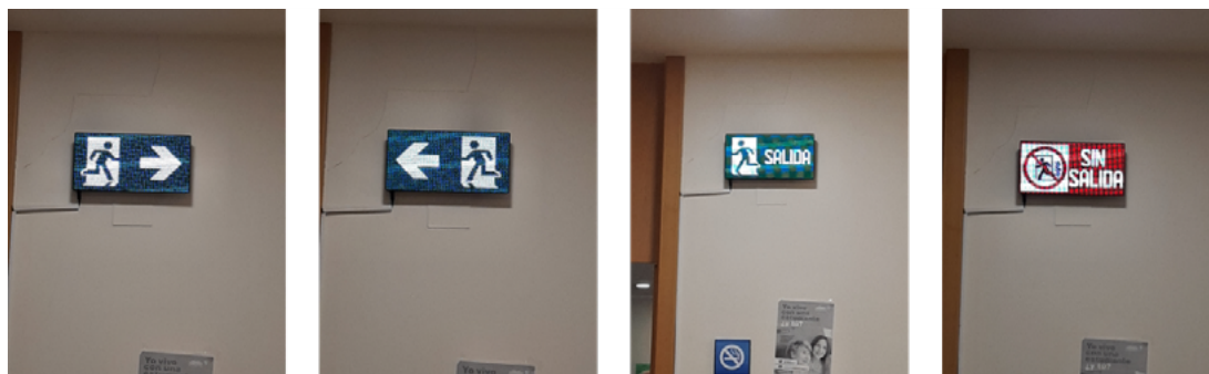
Señalización de evacuación dinámica
